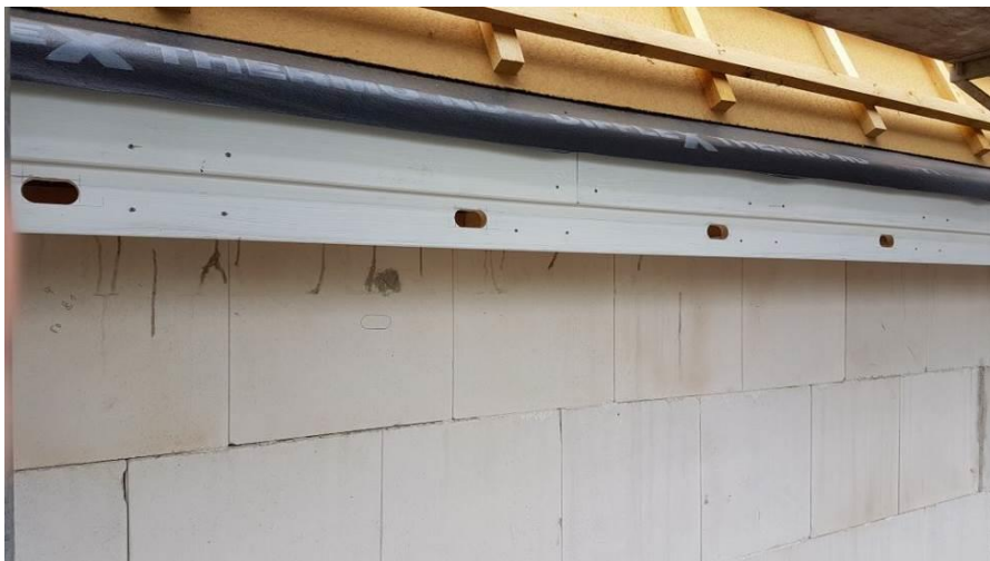
Abb. 12: Privathaus, Neben dem Einbau von Niststeinen in die Fassade wurden auch neue Nistplätze im Gesimskasten eines Neubaus geschaffen.
