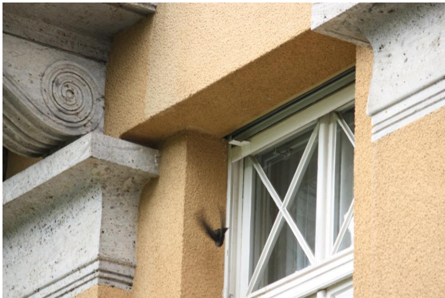
Abb. 10: Mauersegler beim Verlassen eines bereits am Gebäude vorhandenen Brutplatzes im Jalousiekasten, kleine Kotspuren im oberen, linken Winkel des Fensters deuten auf eine regelmäßige Nutzung des Brutplatzes hin.
